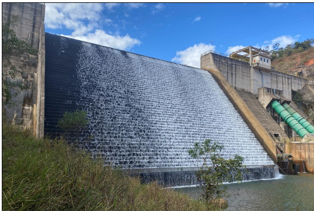
Figura 5.3 - Sistema extravasor da barragem da PCH Senhora do Porto.
