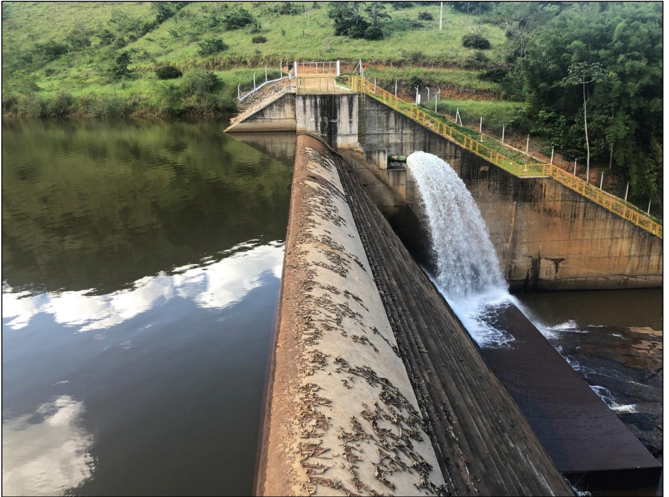
Figura 5.3 - Sistema extravasor da barragem da PCH Fortuna II.
