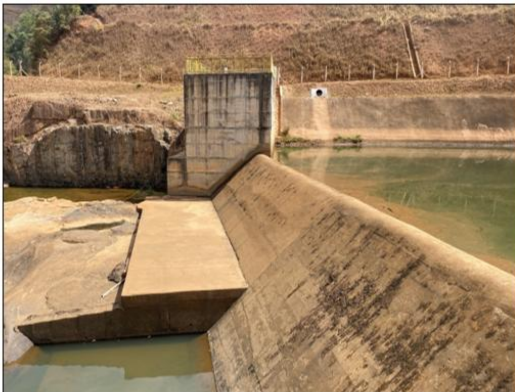
Figura 5-6 – Vista a jusante dos vãos do vertedor da barragem da PCH Dores de Guanhões.
